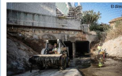
Colapso de toallitas en el colector norte de Valencia. JOSÉ CUÉLLAR
