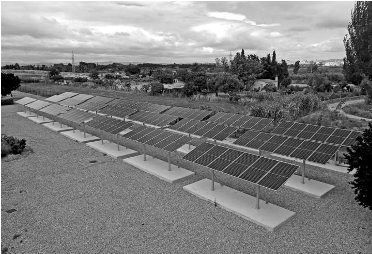
Placas solares en la depuradora de Tudela.
